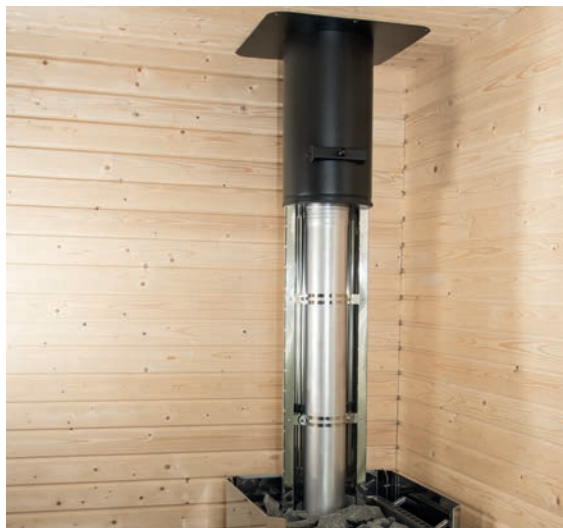
Kuvassa mukana hormisuoja
